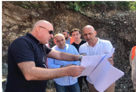
ბაკურიანში ზამთრის სეზონზე სტაბილური წყალმომარაგებით უზრუნველყოფისა და წყლის დებიტის გაზრდის მიზნით, ორი პროექტით გათვალისწინებული დამატებითი სამუშაოები მიმდინარეობს. ამის შესახებ „ინტერპრესნიუსს“ ინფრასტრუქტურის სამინისტროდან აცხადებენ.
